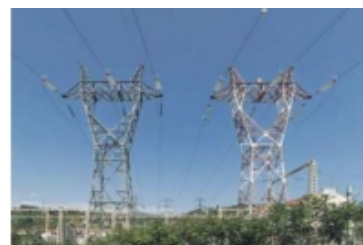
Des pylônes électriques, en France. L'activité sur le réseau est amenée à croître avec le plan d'électrification.
